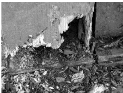
柱子腐爛，白蟻蛀蝕
